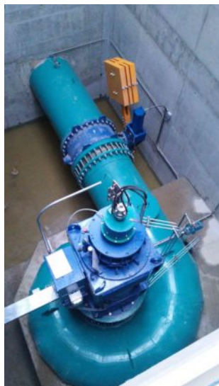
Gli impianti della centralina della Pieve a Silvano
