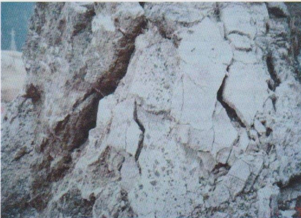
Figura 13 - Versante gessoso originario a monte di Lozzo di Cadore, affetto da estesi dissesti dovuti all'idratazione di anidriti permiane.
