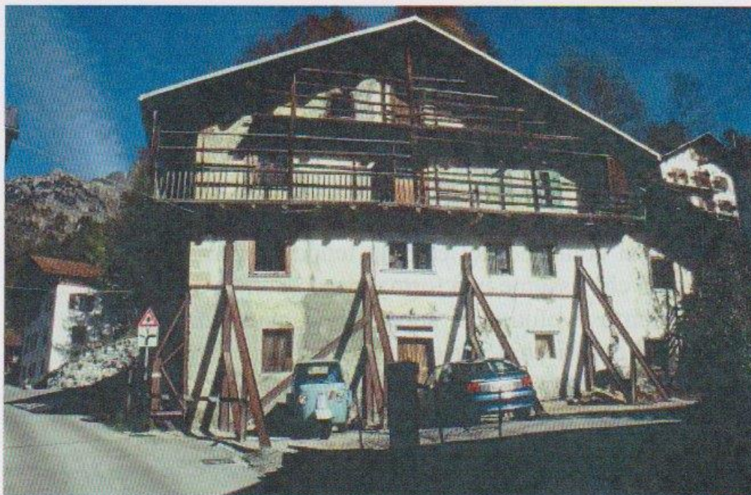
Figura 23 - Vecchio edificio di Andrich (Vallada Agordina) recentemente abbattuto perché pericolante da cedimento carsico.
